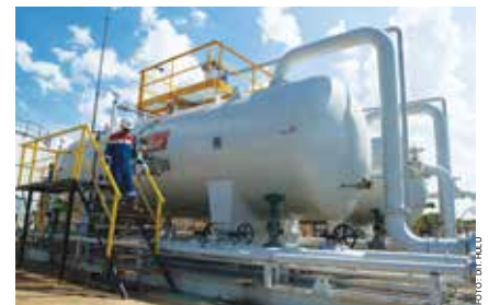
Monitoring, di Stasiun Pengumpul (SP) Bentayan, Ramba Field, Sumatera Selatan.
