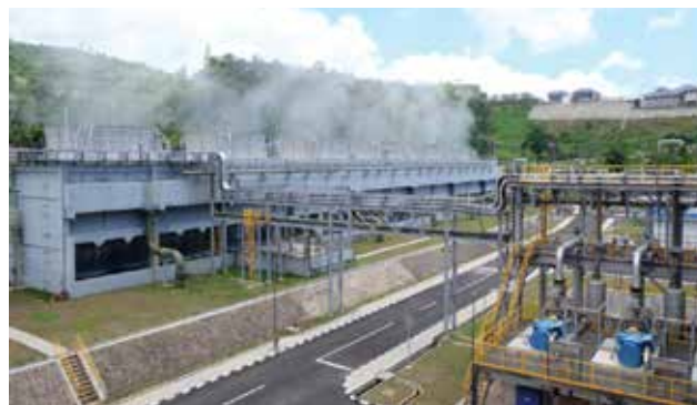
Cooling Tower PLTP Ulubelu Unit 3, Lampung
