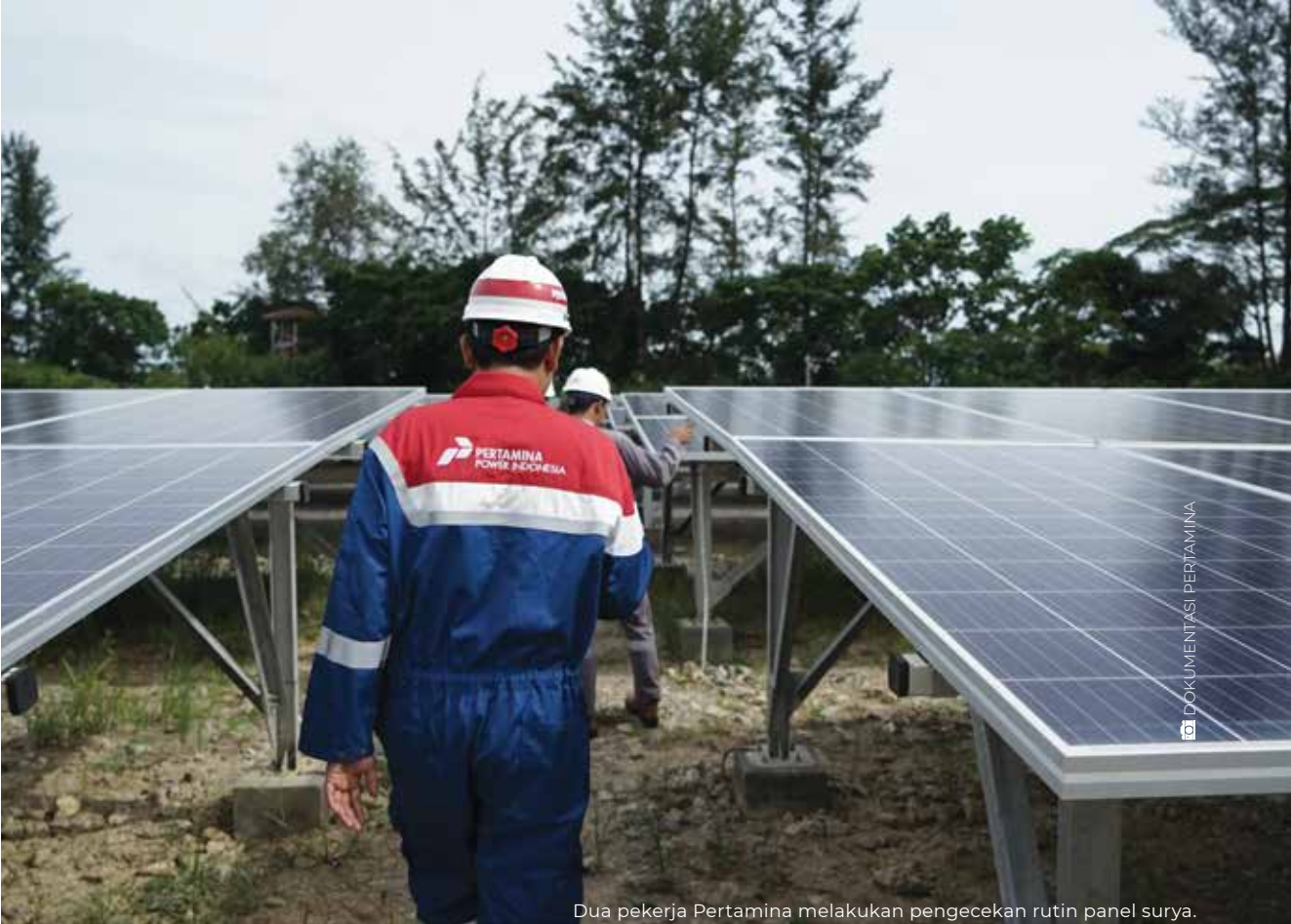
Dua pekerja Pertamina melakukan pengecekan rutin panel surya.
