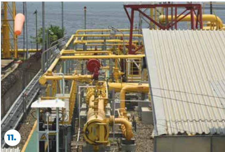
11. Pipa-pipa fasilitas yang digunakan untuk menyalurkan gas sampai ke pembangkit listrik di Muara Karang, Jakarta pada Selasa (12/10/2021). The pipes used for distributing gas to the power plant in Muara Karang, Jakarta, Tuesday (12/10/2021).
