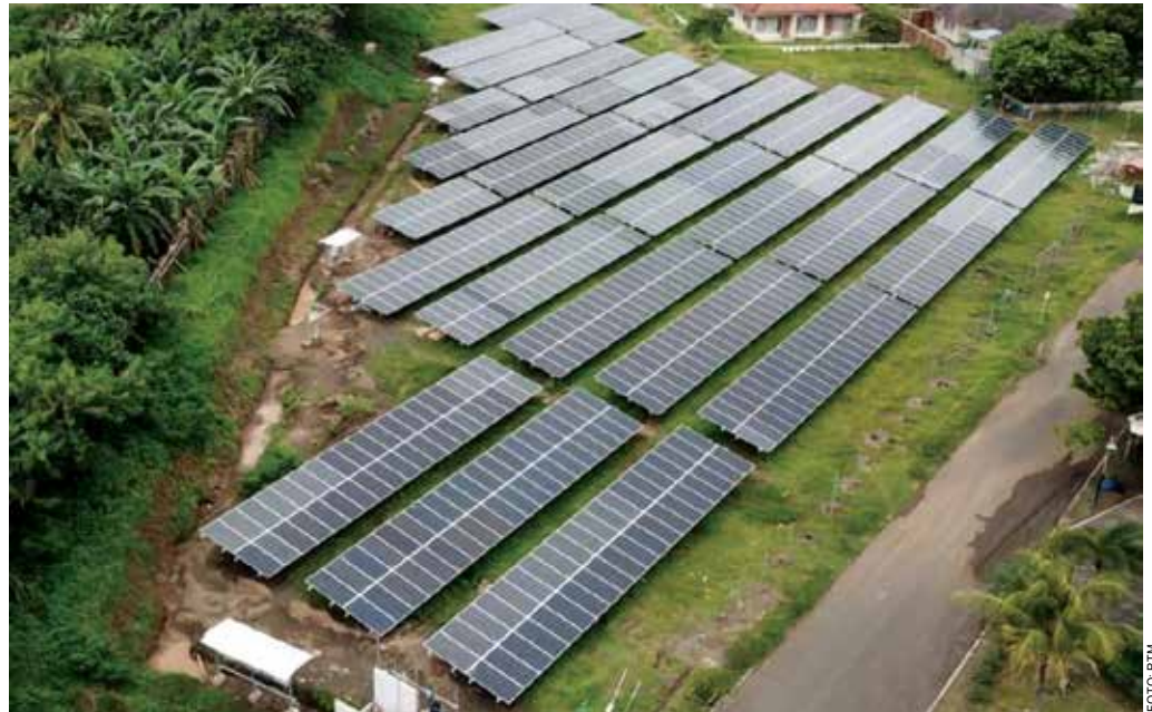
PLTS di wilayah kerja Kilang Cilacap.
