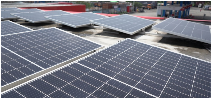
Penggunaan PLTS di SPBU mendukung implementasi Pertamina Go Green.
