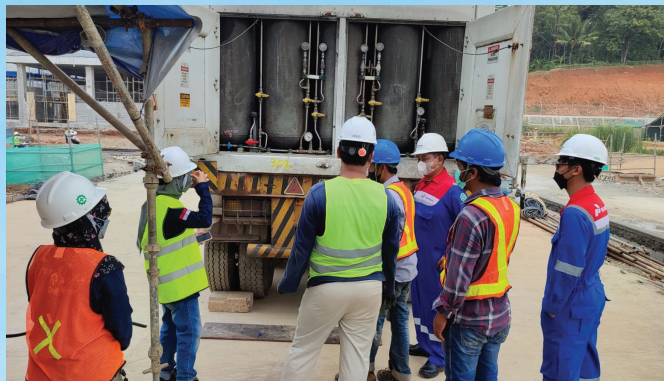
Penyaluran perdana Compressed Natural Gas (CNG) untuk Kawasan Batang Industrial Park, Kabupaten Batang.
