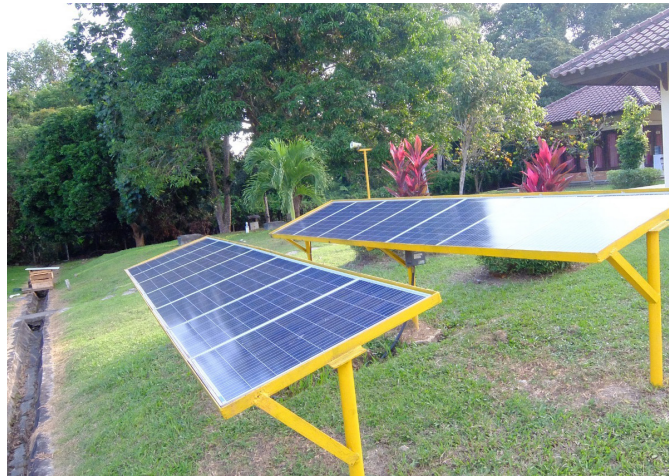
Gedung Mahakam Training Center memanfaatkan pembangkit listrik tenaga surya sehingga ikut berkontribusi pada penurunan emisi.
