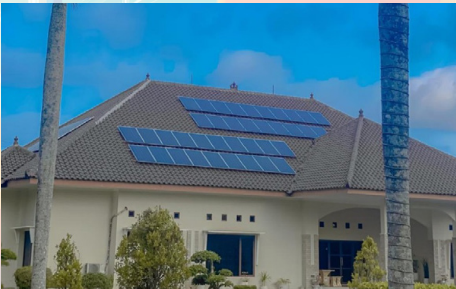
Rumah Dinas General Manager PT KPI RU IV Cilacap menggunakan solar panel
