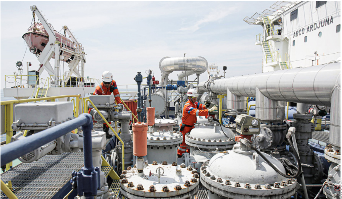
Pekerja migas PHE ONWJ melakukan pengecekan fasilitas produksi Floating Storage Offloading (FSO).
