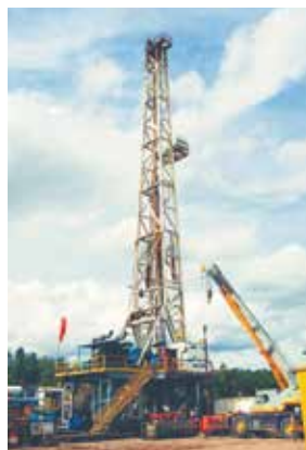
Pengeboran sumur MJ-AA5 menggunakan Rig N55 milik PT PDSI, di Ramba Field, Sumatera Selatan.
